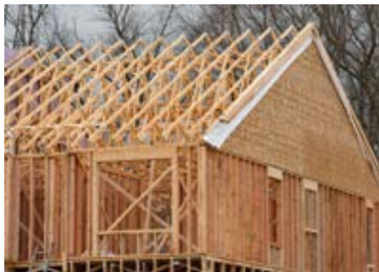
Zdj.9.4 Ściana szczytowa w technologii szkieletu drewnianego
