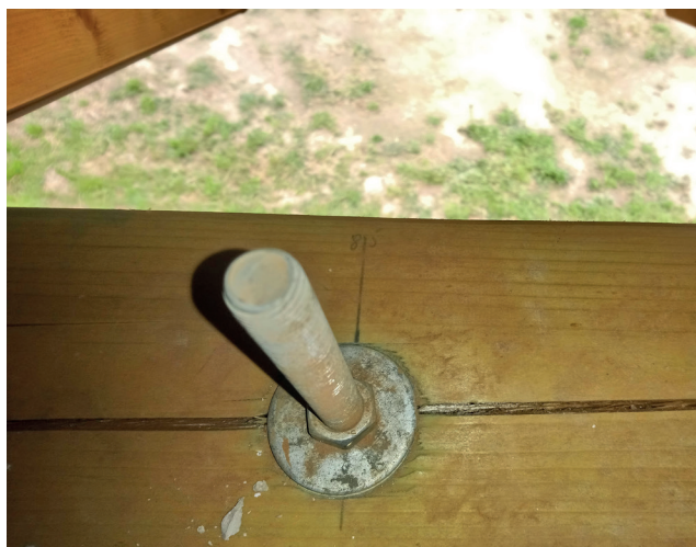
Zdj. 4. Rozwarstwienie murlaty wzdłuż linii rozmieszczenia szpilek
